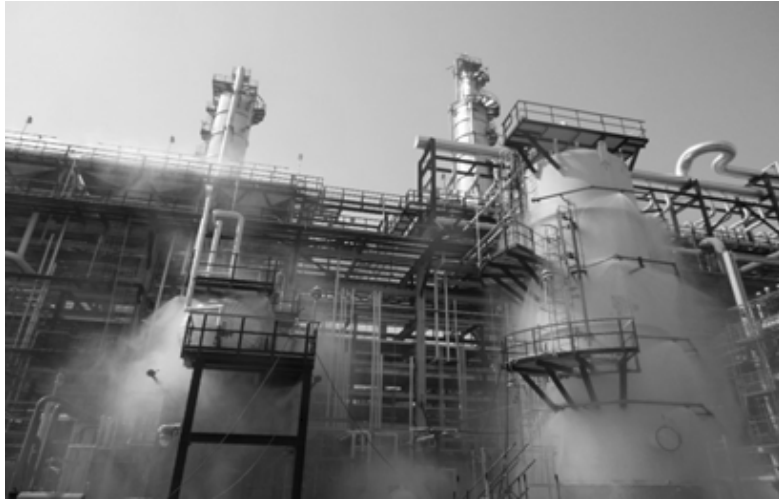
&lt;그림 7.5&gt; 대상 공정의 water curtain 설치 사례
